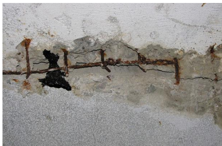
Рисунок 3 – Коррозия арматуры в железобетонной конструкции
