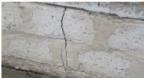
Рисунок 2 – Трещина в фундаменте
