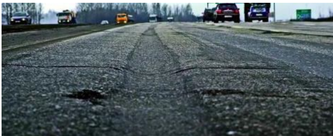
Рисунок 3 – Характерная деформация дорожного полотна
